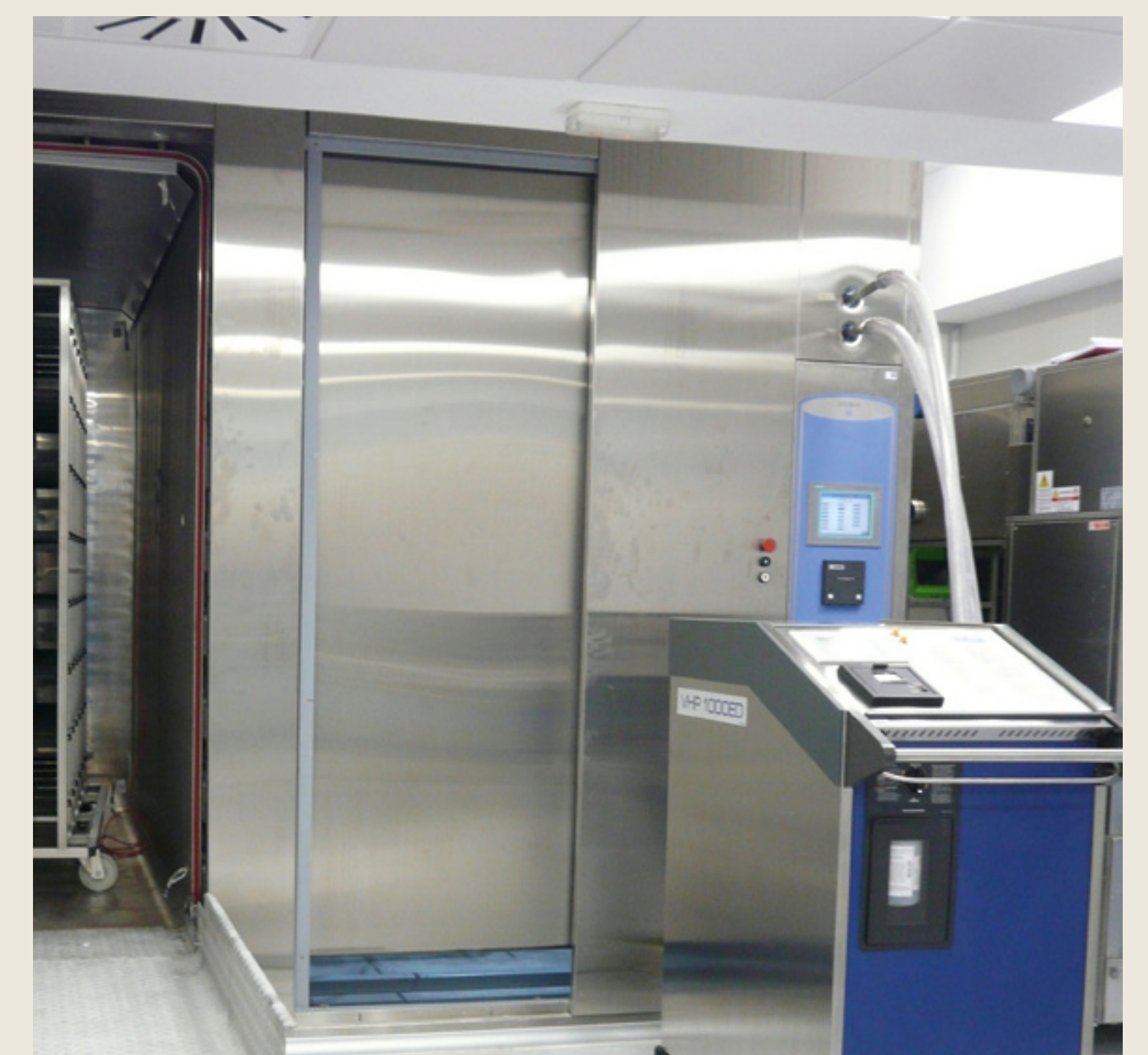
Begasung von Tierkäfiggestellen in einer Materialschleuse
